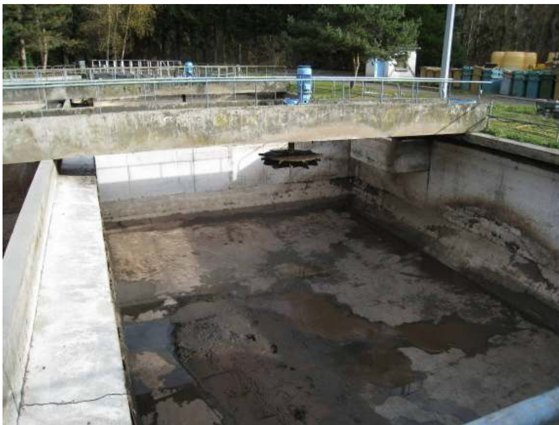
Bassin vidangé de la station d'épuration d'Amancy
